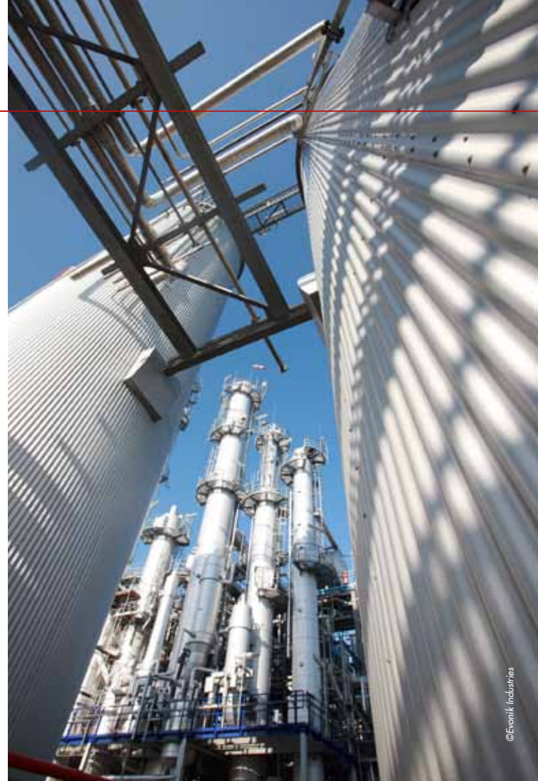
SAMSON-Stellventile werden auch bei Evonik, einem internationalen Unternehmen der Spezialchemie, eingesetzt.
